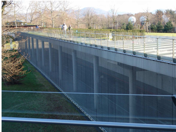
Abb. 8: Das Glasgeländer oberhalb der Tiefgaragenzufahrt (Nordseite), vom Turm her gesehen. Im Vordergrund weitere Glaselemente mit Handlauf.
